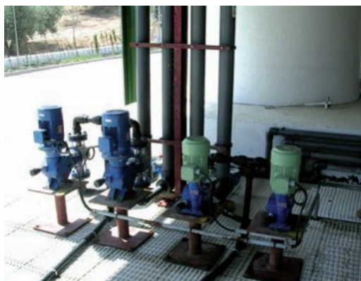
Instalación de fertirrigación: bombas dosificadoras eléctricas
